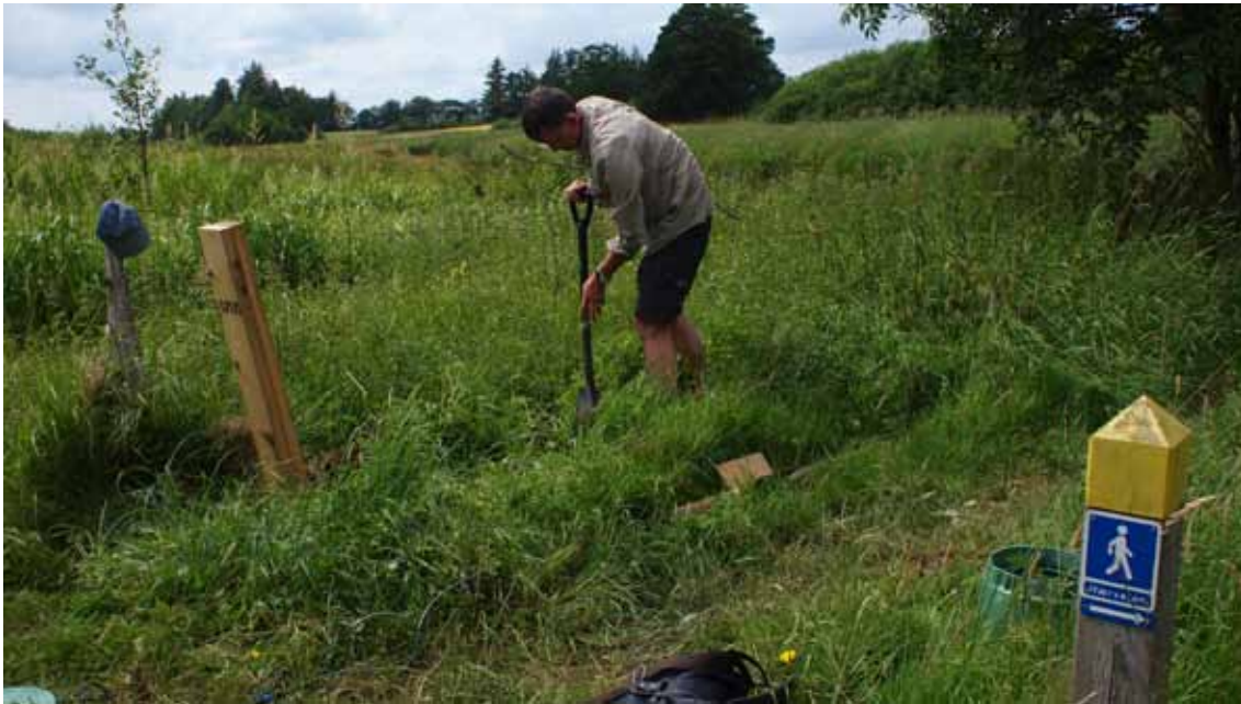
Figur 1: "Passage tælleren" under opstilling ved Kongeåen, sensoren findes indbygget i den viste stolpe tv i billedet.
